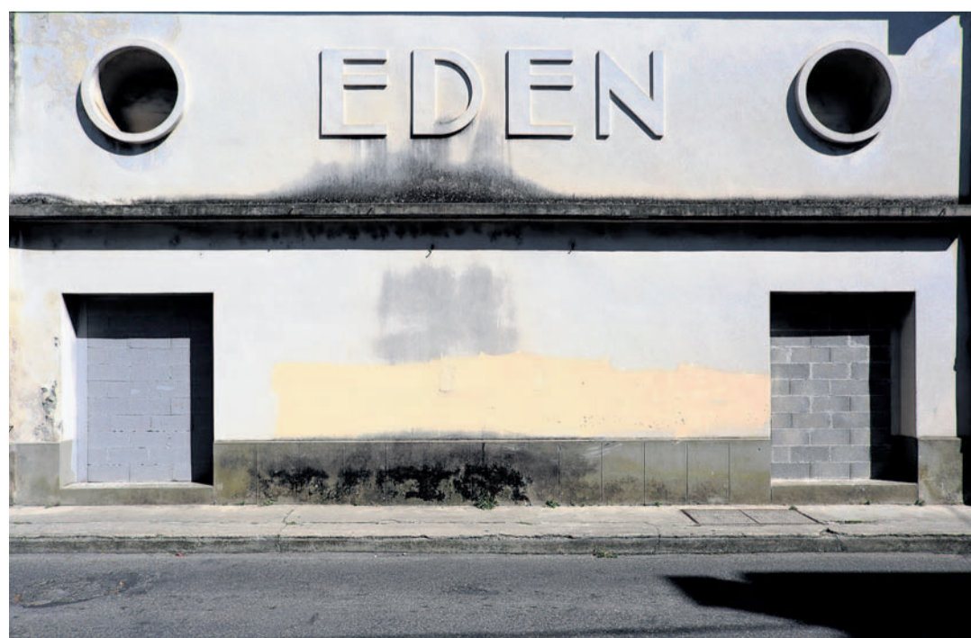
Cinéma Eden (années 1950), Ganges (Occitanie), photographié en 2016. Abandonné et ravagé par un incendie en 2023.
